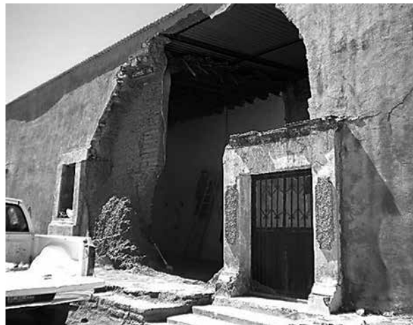
Figura 3. En la iglesia de la misión de Ónavas, localizada en la Pimería Baja, se observan actualmente deterioros irreversibles y alteraciones a la fábrica de la iglesia. Fotografía Centro INAH Sonora, Ónavas, noviembre de 2011.
