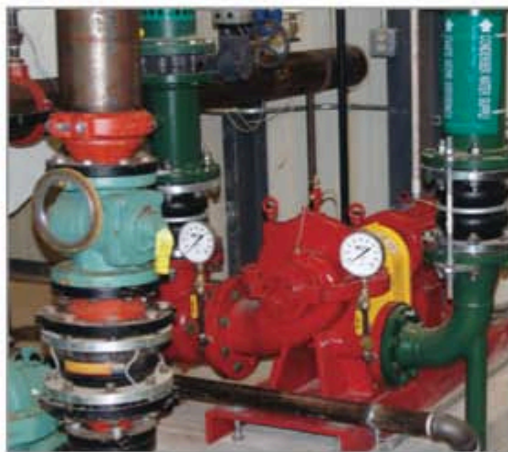
Instalación 'verde' de alto rendimiento.
