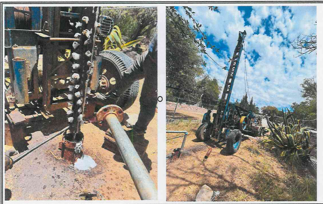
EQUIPAMIENTO DE POZO DE AGUA POTABLE UBICADO EN EL PARQUE DE OJO DE AGUA, LA GALERA VILLA GARCÍA ZACATECAS.
