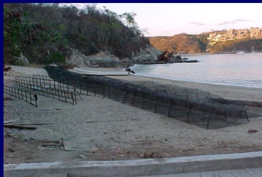
Gavión cúbico, de 38 m de longitud.
