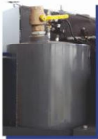
Tanque de Água Tanque de Agua Water Tank
