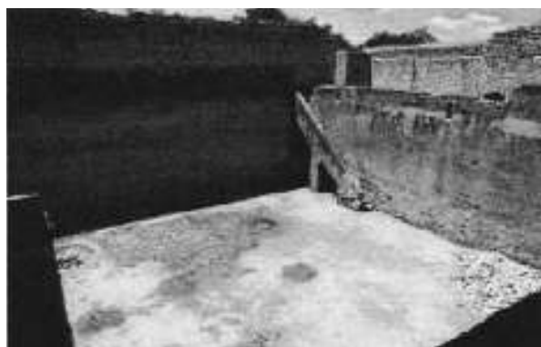
Figura 32. Aljibe del ex convento de Tecali, Puebla.
