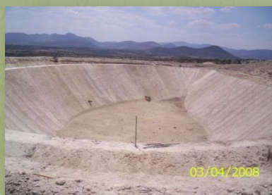
Fig. 1a: Uno de 3 lagos de 11 m de profundidad impermeabilizados con GEOVIN® en el estado de Hidalgo. Año 2008
