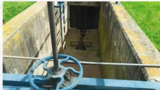
Pretratamiento y medidor tipo Parshall en cárcamo de bombeo, Tapalpa.
