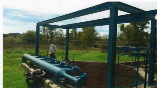
Cárcamo de bombeo, Tapalpa.
