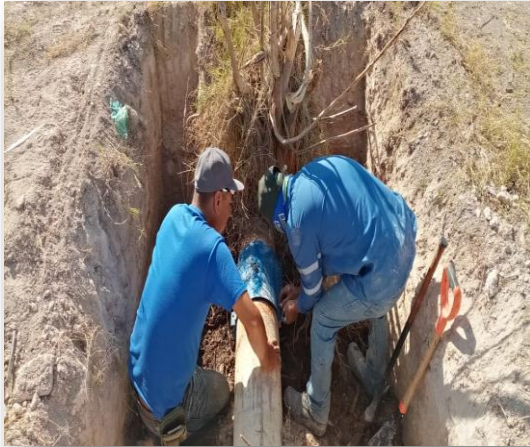
Colocación de abrazadera por fin de vida en Pozo Santa Martha
