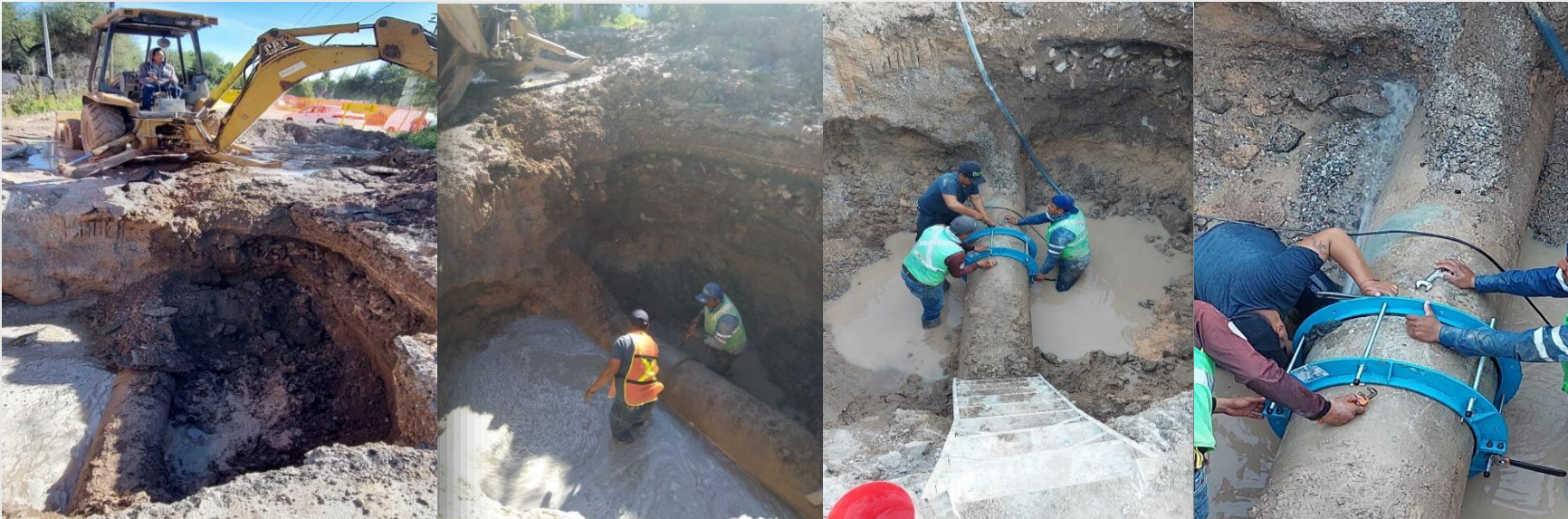
Fuga en red general en acueducto oriente de 20" asbesto/cemento, en prolongación Hidalgo, por la curva al Ojo de Agua, se sustituye coplee dañado.
