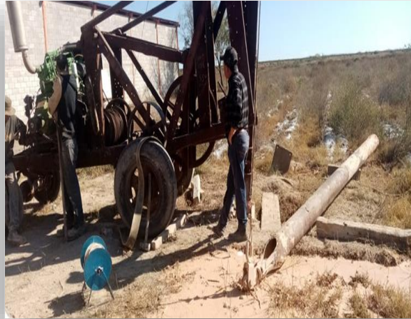
Desazolve de pozo en Rancho Santa Martha para perforación de nuevo pozo dentro de la misma propiedad.
