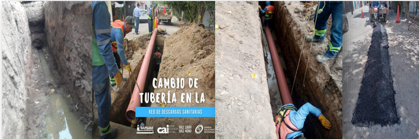
Rehabilitación de la red de drenaje, cambiando 14 mts de tubería de pvc sanitario de 10" en la calle Ferrocarrilera
