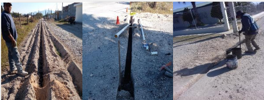
Calle Aguascalientes entre Irapuato y Guerrero en la colonia República
