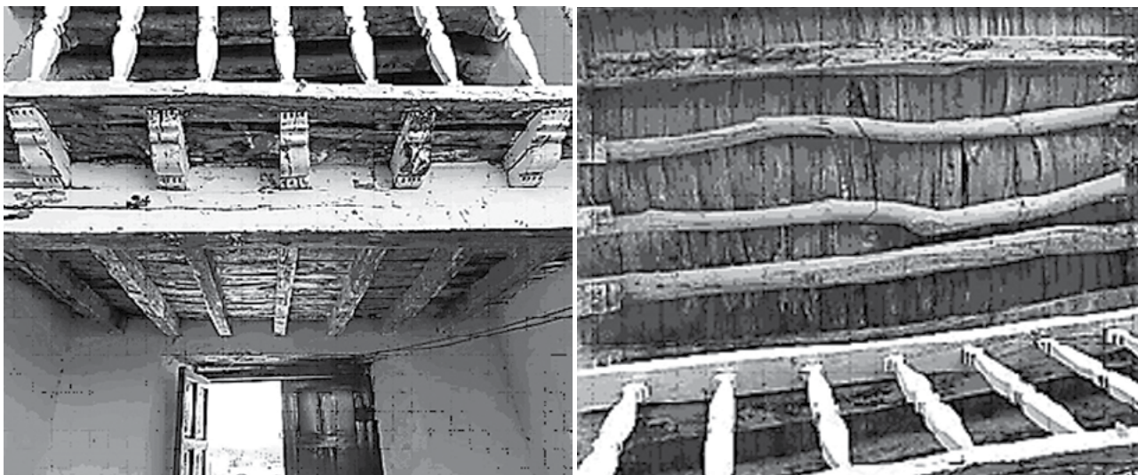
Figura 9. Vista actual del templo jesuita de San Felipe, en el municipio de Valle de Zaragoza, Chihuahua, donde a pesar de los daños severos y falta de mantenimiento aún se observan diversos detalles de la calidad de la obra misional. Fotografías de Francisco Hernández Serrano, 2014.
