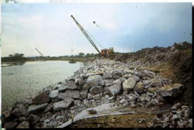
Protección de los taludes de una marina comercial, empleando PAVITEX® como filtro. Marina Mazatlán, 1993.
