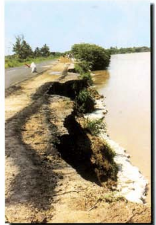
Falla por erosión del talud de una carretera, ocasionada por corrientes fluviales
