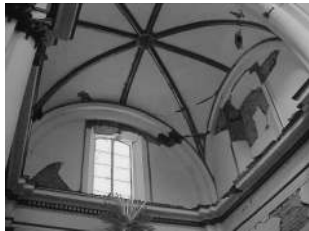
Figura 4. Detalle de daños provocados por el sismo en cubiertas y muros del inmueble, 2003. Archivo de la SMH-Centro INAH Colima, exp. Templo del Sagrado Corazón, Sismo 2003.
