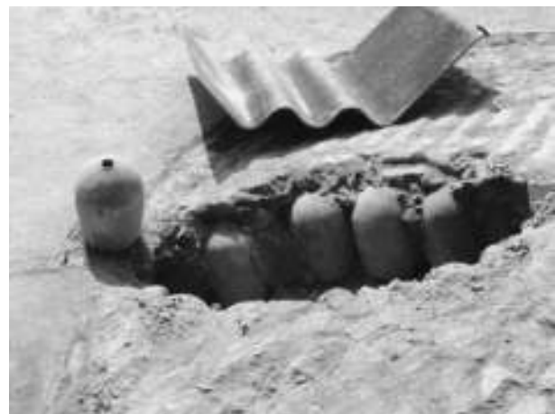
Figura 12. Detalle de sustitución de elementos constructivos en bóveda del inmueble, 2004. Archivo de la SMH-Centro INAH Colima, exp. Templo del Sagrado Corazón, Sismo 2003.
