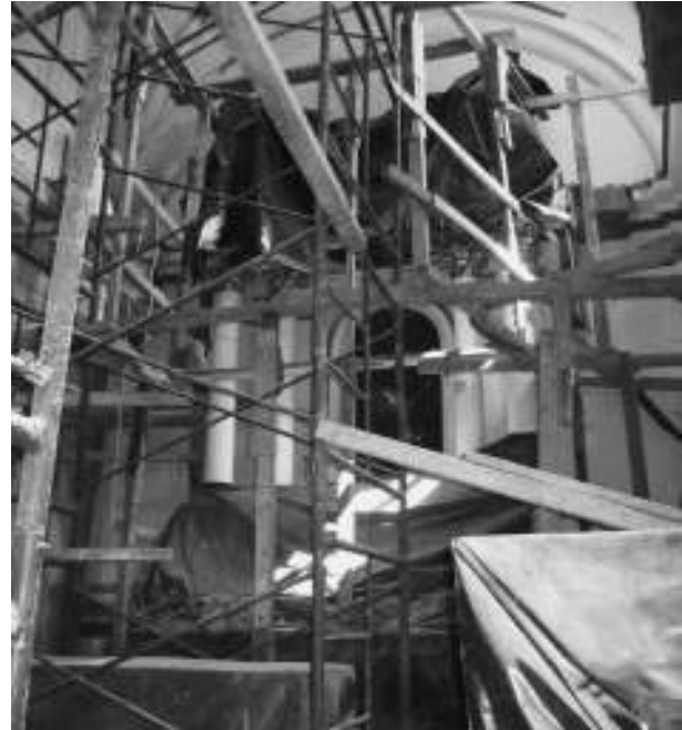
Figura 11. Apuntalamiento al interior del inmueble 2003. Archivo de la SMH-Centro INAH Colima, exp. Templo del Sagrado Corazón, Sismo 2003.
